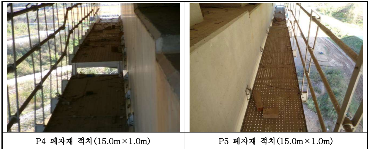
【사진 10.3.26】 교량 점검시설 손상현황
