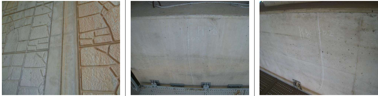
① 하부구조 균열(0.3mm 미만) 등 - 진전 여부확인
